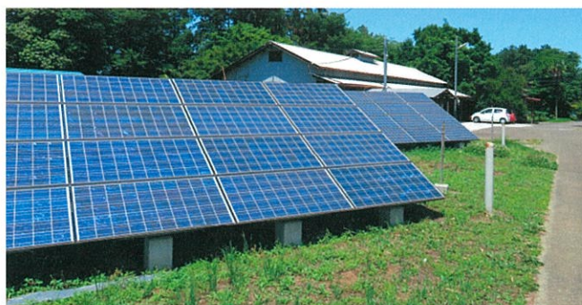
現在の村の様子 太陽光パネルで発電した電気を電力会社に売っている
